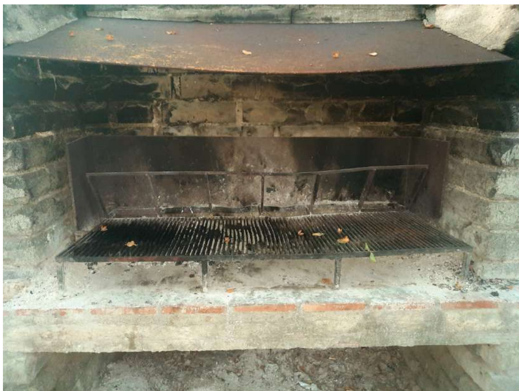
Barbecue da sottoporre a manutenzione.
