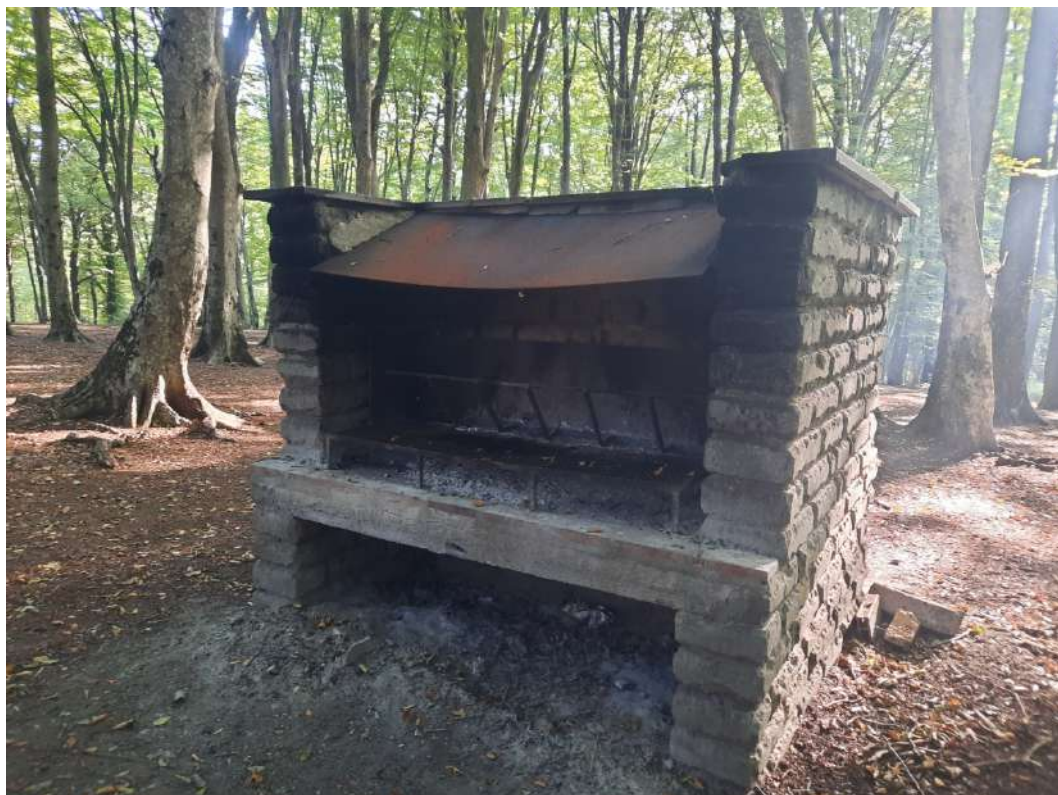
Barbecue da sottoporre a manutenzione.
