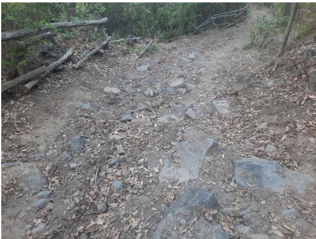
Tratto del piano viario da sottoporre a manutenzione.
