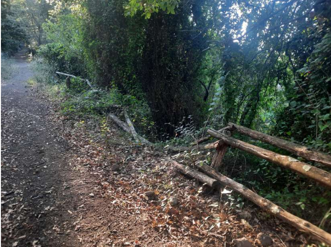
Staccinata da rimuovere e sostituire.
