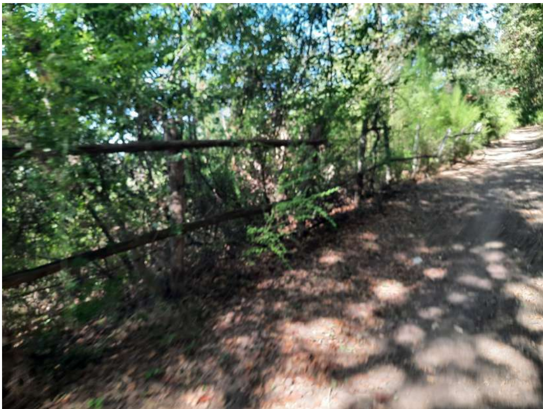
Staccinata da sottoporre a manutenzione.
