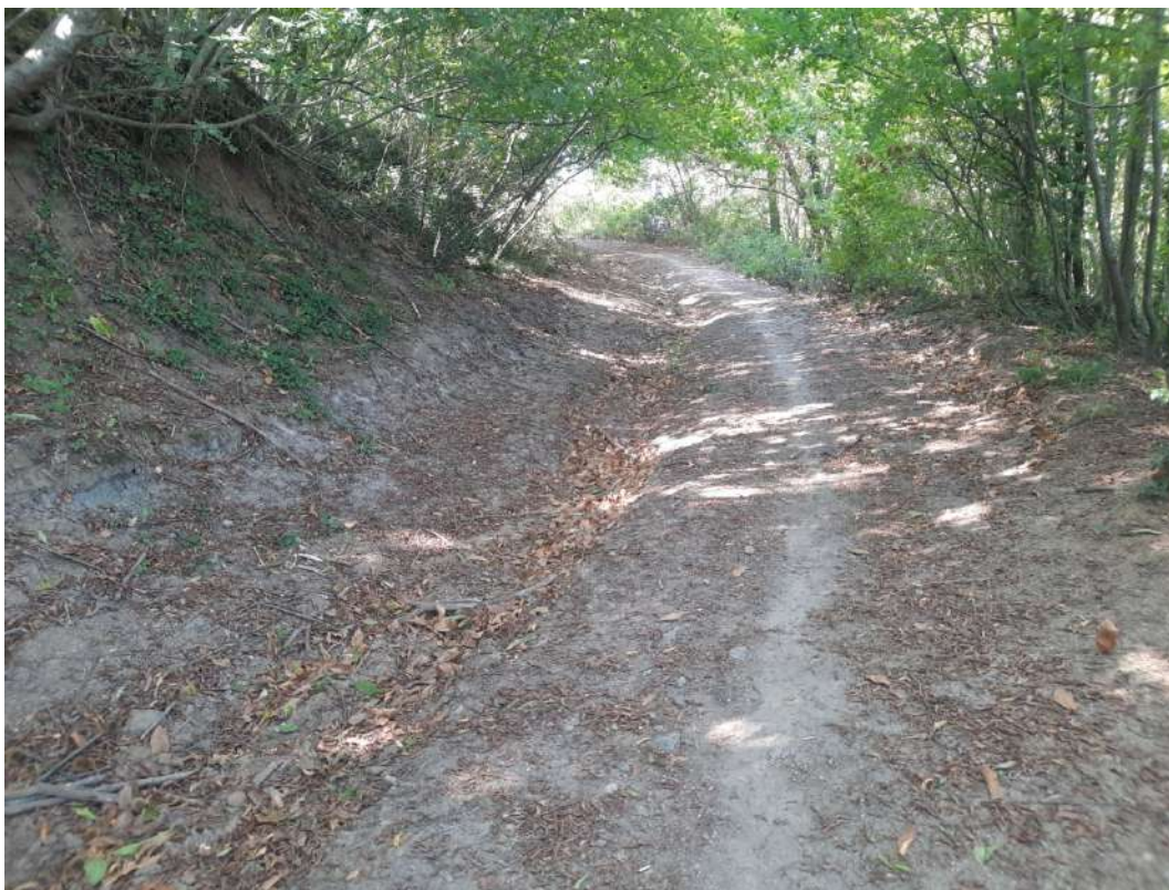
Tratto di viabilità da sottoporre a manutenzione.
