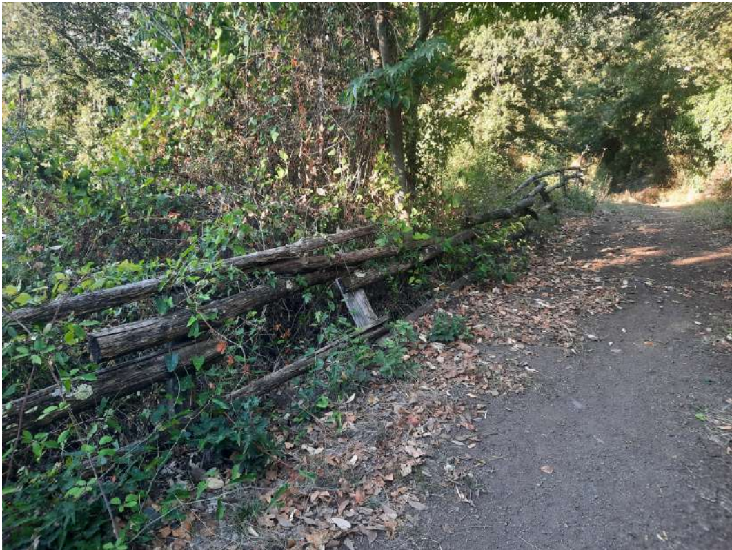
Staccinata da rimuovere e sostituire.
